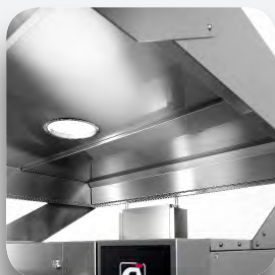
Conducto humos y campana.
