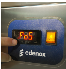
Control de ciclos mediante termostato
